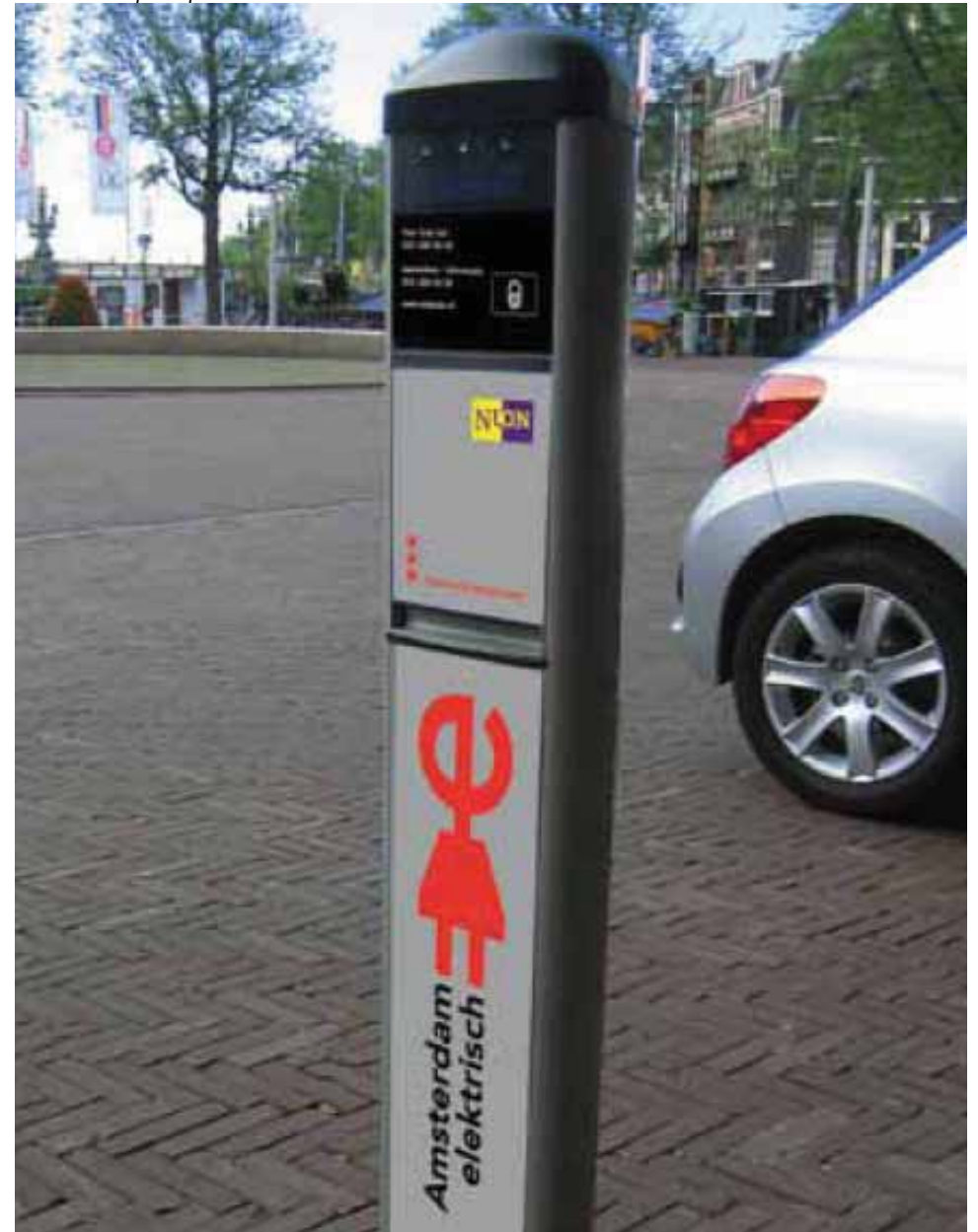
electrische oplaadpunt voor autos in Amsterdam
